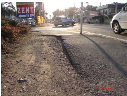
写真5 進行方向に平行な段差。国道354、ヤマダデンキ近くの歩道
