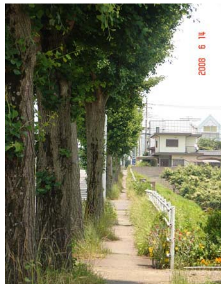
写真4 生長して歩道をふさぎ根による地盤持ち上げが起きている街路樹
